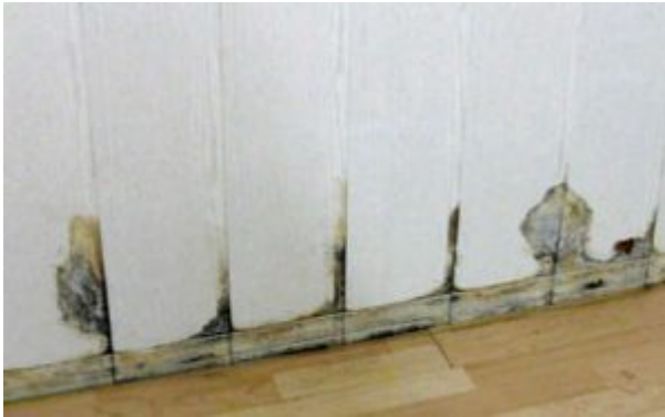
Massiver Schimmelbefall im feuchten Bereich einer Wandverkleidung.
