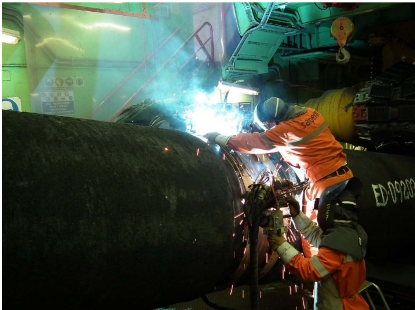
Schweißarbeiten an der Pipeline Nord Stream I (Bild: Bair175 , Creative Commons Attribution-Share Alike 3.0 Unported )
