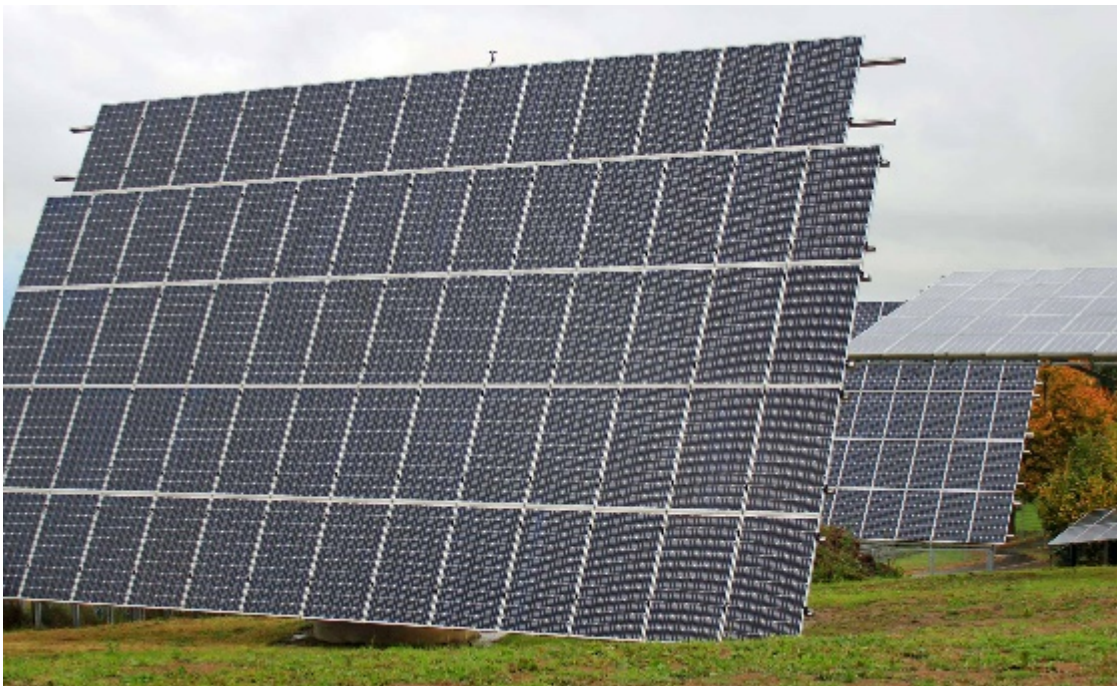
Solaranlagen liefern im Winter kaum und nachts gar keinen Strom (Foto: Privat)
